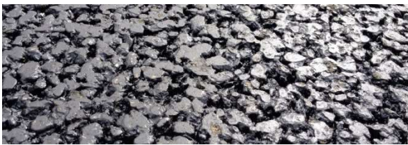
Figur 24. Nærbillede af et nyt og mindre støjende slidlag (teknisk betegnelse: SMA-8). Både den meget jævne og åbne overfladestruktur ses tydeligt. En traditionel belægning (f.eks. SMA-11) har en grovere og mere ujævn struktur.
