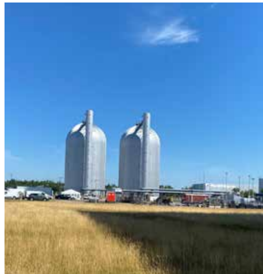
Varmeakkumulatører til fjernvarmeanlægget mod vest.
